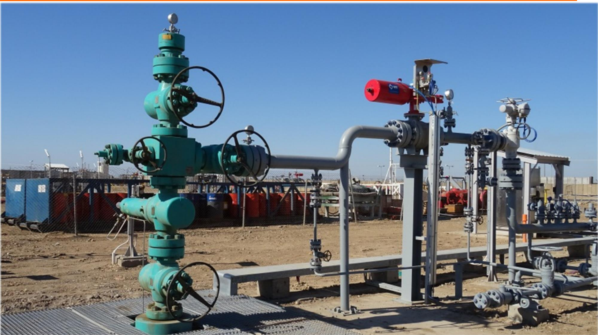
ガラフ油田で原油を生産する油井
