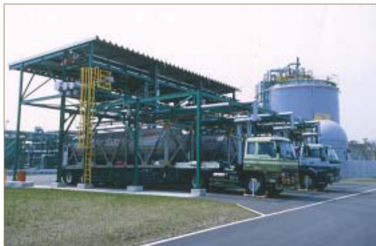
勇払LNGプラント
