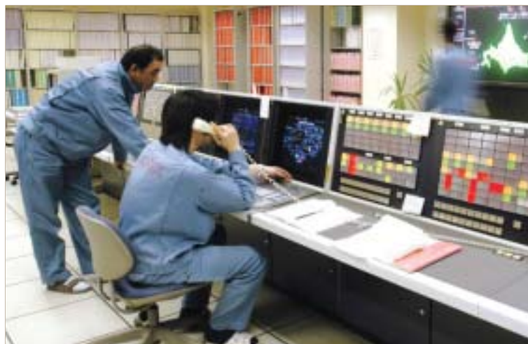
勇払中央基地 コントロールルーム
