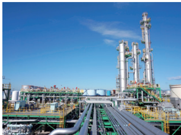
苫小牧実証プロジェクト地上設備／写真提供：日本CCS調査(株)
