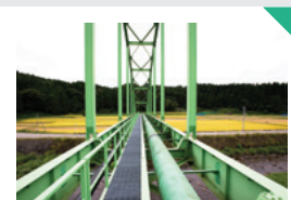
新潟・仙台間ガスパイプライン
