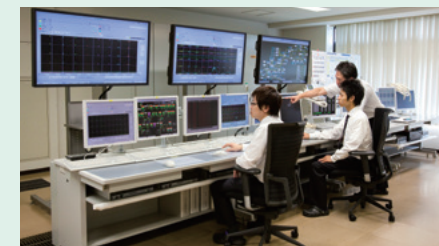
長岡送ガス監視センター
