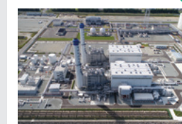
福島ガス発電(株)福島天然ガス発電所
