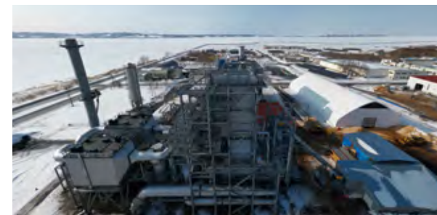
北海道 網走バイオマス発電所3号機
