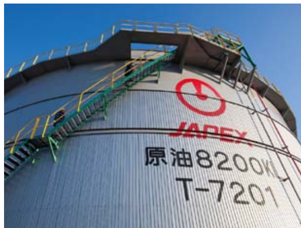
勇払油ガス田の原油タンク
