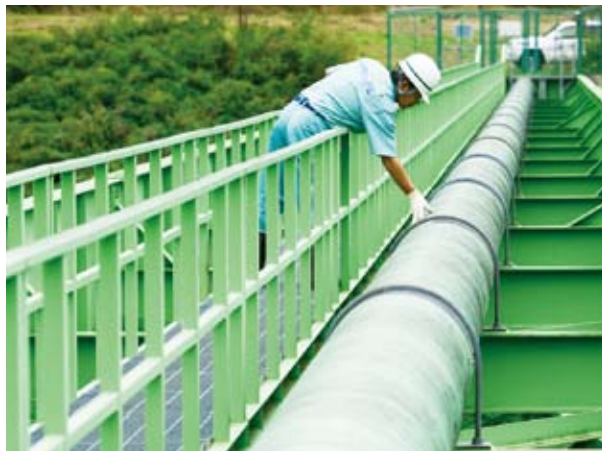
新潟-仙台間パイプライン
