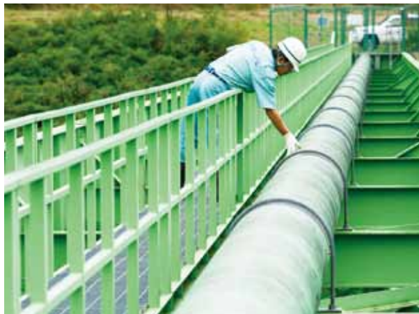
新潟-仙台間パイプライン
