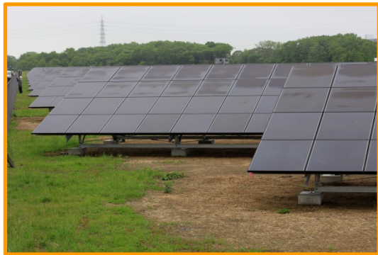
北海道鉱業所メガソーラー発電所
