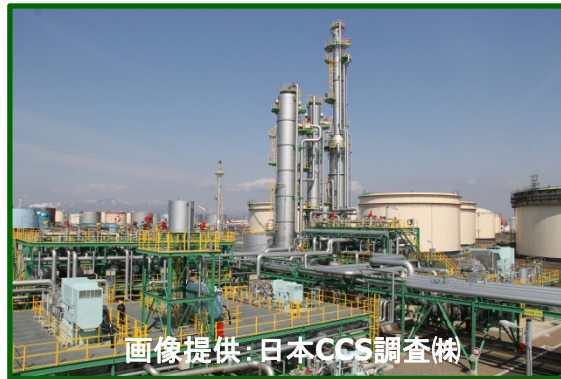
苦小牧CCS実証プロジェクト地上設備
